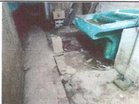
Foto 1: Sustrucción de piso de torta de concreto
