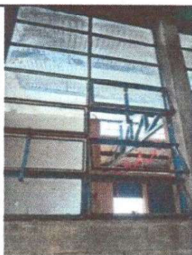
Foto 3: Sustrucción de vidrios
